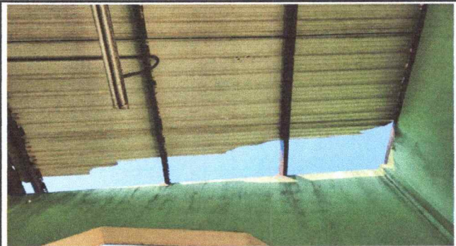
Foto 4: en esta fotografía se visualiza la cubierta y la estructura de metal deteriorada.
