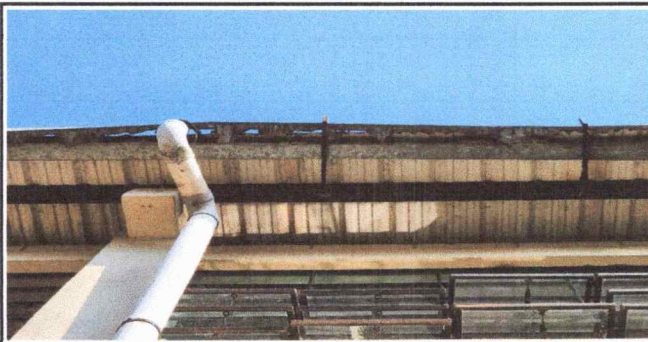
Foto 5: en esta fotografía se visualiza el deterioro de los canales pluviales
